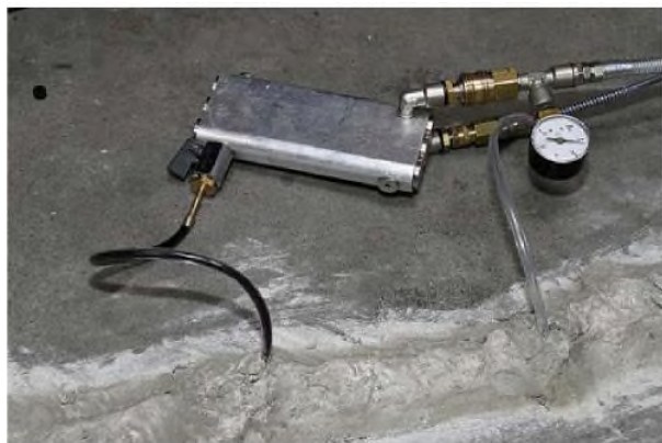
Figure 3. Injectarea MasterInject 1380 cu pompa bicomponenta de injectare, pentru repararea unei pardoseli fisurate
